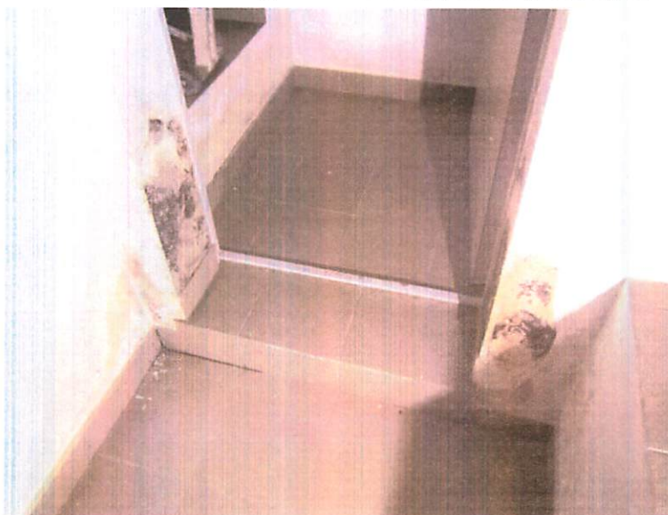
Fot. 9. Zawilgocenie i zagrybienie ścian wewnętrznych budynku
