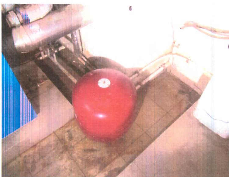
Fot. 12. Ślady zaciekania i spływu wody po posadzce od strony zmiękczacza wody.
