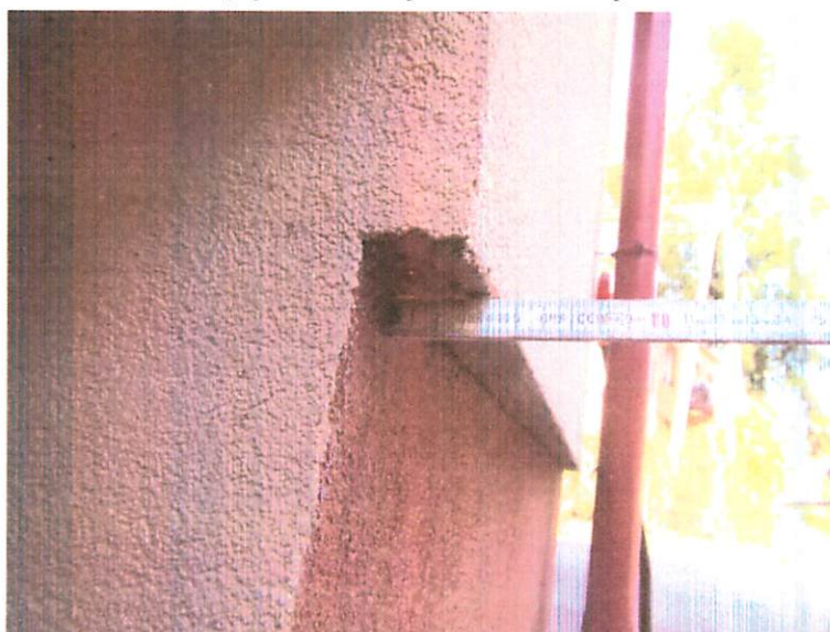
Fot. 5. Brak listwy okapnikowej na uskoku izolacji termicznej ścian.
